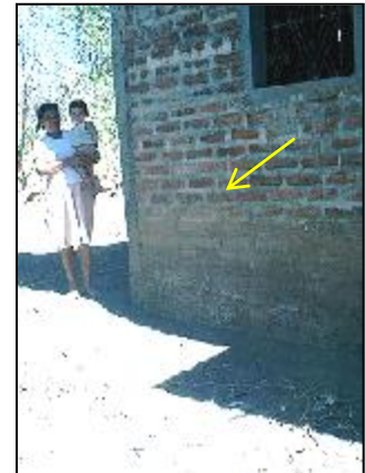
Foto 18-Altura del lodo en la casa a 30m. de la Quebrada El Cargadero..Inundación junio2001.
