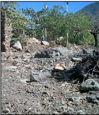
Foto 17- zona de sedimentación, pérdida de capacidad del cauce. Quebrada El Cargadero. Viviendas en margen izquierdo.
