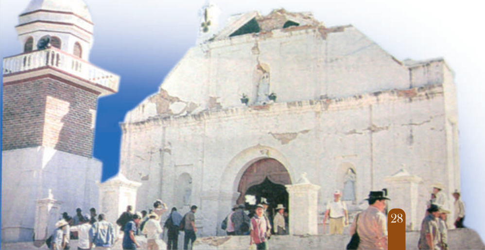
Iglesia de Santa María Ostuma. Terremoto del 2001
