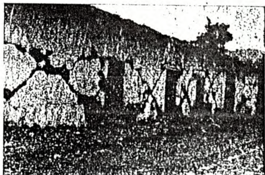
Foto 4. Chinameca. Grietas diagonales típicas en una pared de adobe, orientada de poniente a oriente.
