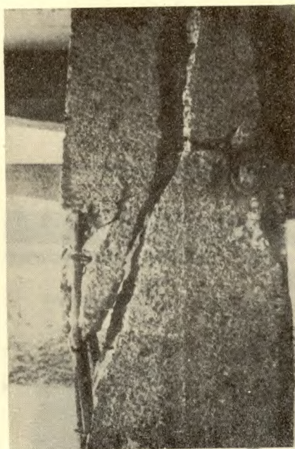
FIG. 10 FALLA EN EDIFICIO DEL GRUPO ABC (Observar el detalle de doblado del refuerzo)
