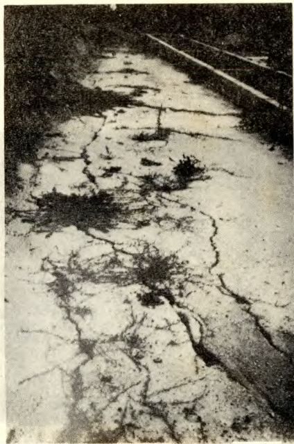
FIG.38 AGRIETAMIENTO DEL TERRENO EN EL INTERIOR DEL EDIFICIO F
