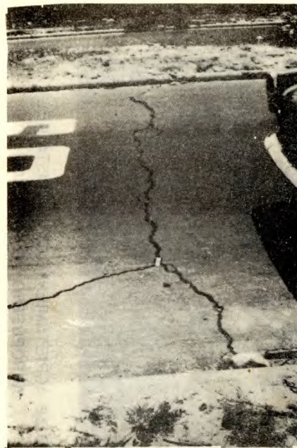
FIG.39 GRIETA EN PAVIMENTO
