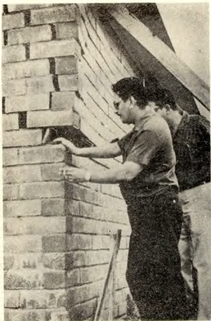
FIG. 15 FALLA DE MUROS DEBIDA A FALTA DE DOBLEZ DEL REFUERZO
