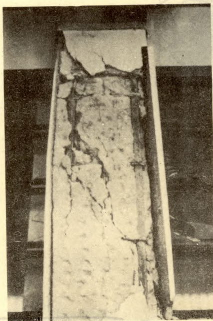
FIG.7 COLUMNA CONSTRUIDA PROBABLEMENTE CON CONCRETO DE BAJA RESISTENCIA
