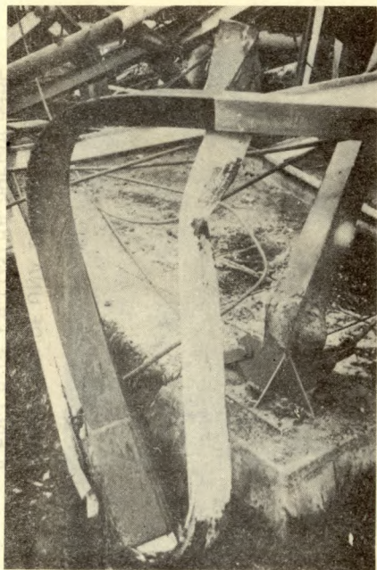
FIG.28 APOYO DEL TANQUE METALICO QUE SUFRIO COLAPSO EN LA FABRICA F
