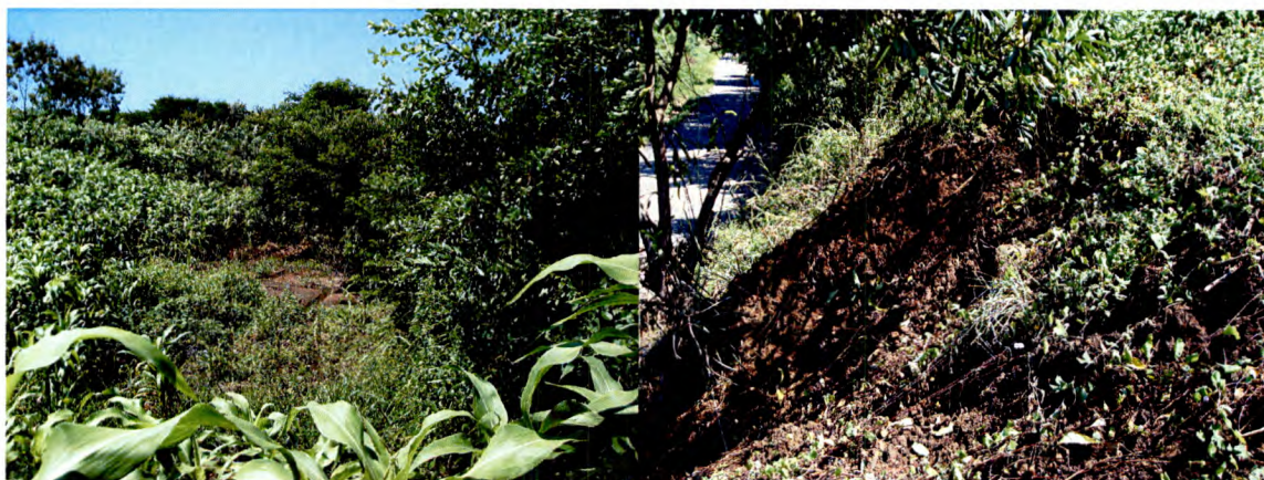
Fotografía mostrando el deslizamiento que afecta a la calle que conduce al Cantón San Lucas, lo cual obstruye la canaleta del drenaje y se inunda este sector.
