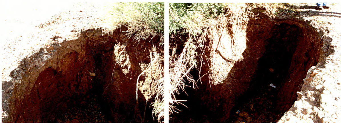
Fotografía mostrando el hundimiento en la calle que conduce de Cuisnahuat a San Julian, por lo cual se recomienda estabilizar este lugar mediante la construcción un muro de retención y en la ladera implementar obras de conservación de suelos.
