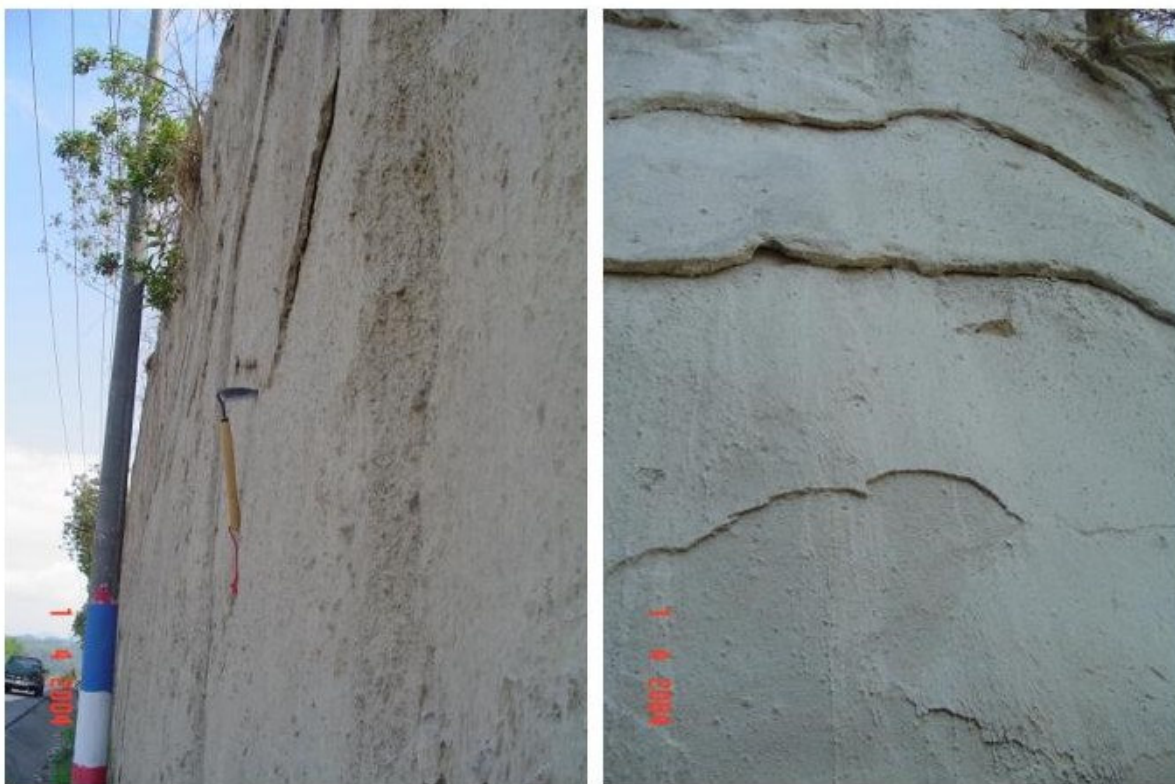
Figura 34. Discontinuidades paralelas a la cara del talud en ignimbritas de textura fina (Unidad G), mostrando rebanadas muy delgadas del orden de pocos centímetros.
